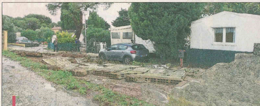
Plus de peur que de mal à l'arrière du camping Lou Souleï : le mur de protection s'est écroulé sur dix mètres.
